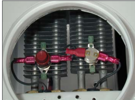
Temperaturwächter und Temperaturbegrenzer (Abdeckung entfernt)
