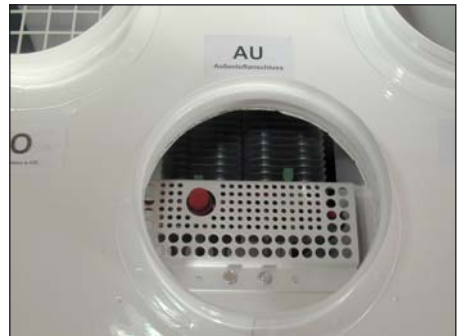
Taster für die manuelle Rückstellung des Temperaturwächters (Außenluft)
