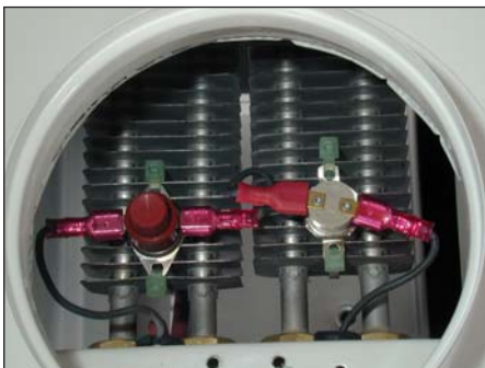
Temperaturwächter und Temperaturbegrenzer (Abdeckung entfernt)
